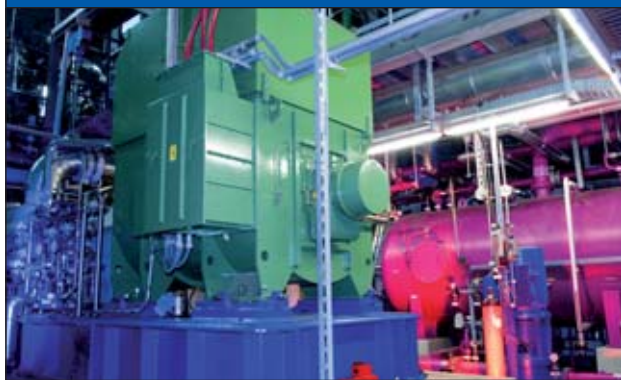
Abb. 9: Generator und Ammoniakbehälter
